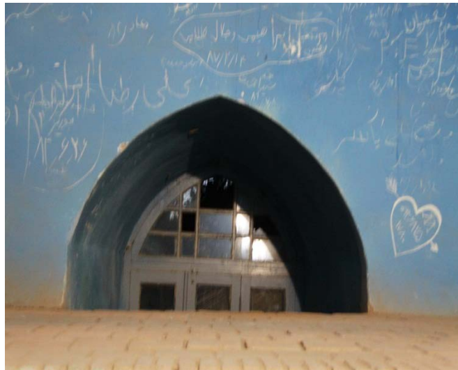
یکی از پنجره های کوشک: نصف پنجره پایین تر از سطح کف راهرو است.
